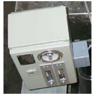
Oben: Versorgungseinheit für eine gasgeschmierte Gleitringdichtung, ausgestattet mit Wartungseinheit, Manometer mit Druck-Tief-Schalter und Durchflussmessern mit Durchfluss-Hoch bzw. Durchfluss-Tief-Schaltern.
